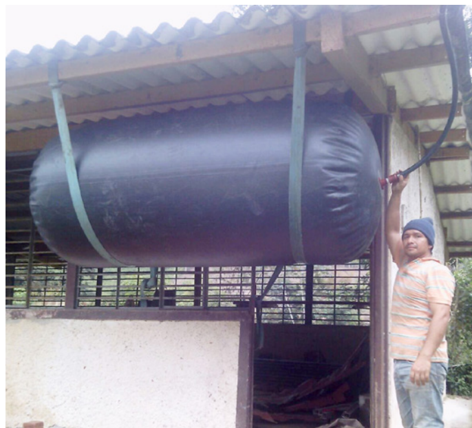
Ilustración 23. Reservorio de geomembrana. Proyecto GENCAPER - MAE, 2015.
