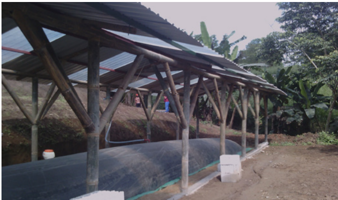
Ilustración 31. Protección externa de un biodigestor. Proyecto GENCAPER - MAE, 2015
