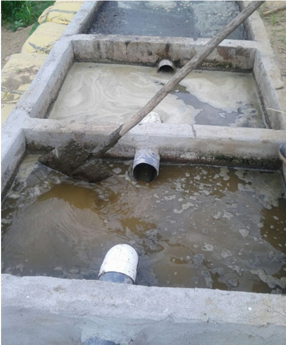
Ilustración 14. Separadores de sólidos por flotación. Proyecto GENCAPER - MAE, 2015.
