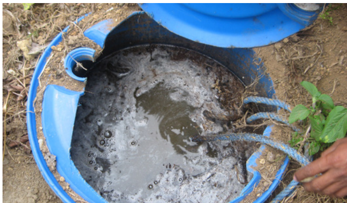
Ilustración 8. Salida de biol desde un biodigestor en una granja porcina. / Fuente: Axionar Consultores C.L.
