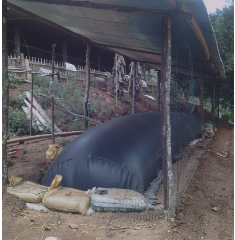
Ilustración 32. Biodigestor en granja porcina. Proyecto GENCAPER - MAE, 2015
