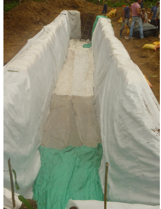
Ilustración 22. Protección de la zanja donde se albergará biodigestor / Fuente: Proyecto GENCAPER - MAE, 2015.
